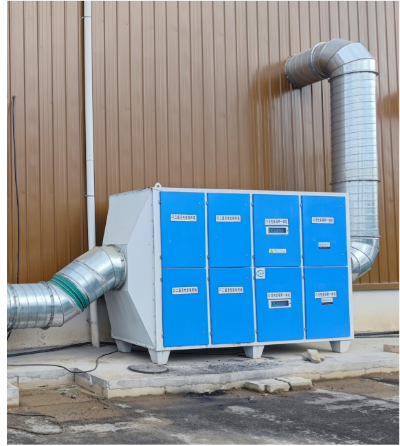
图 4.1-5 注塑废气处理设施
