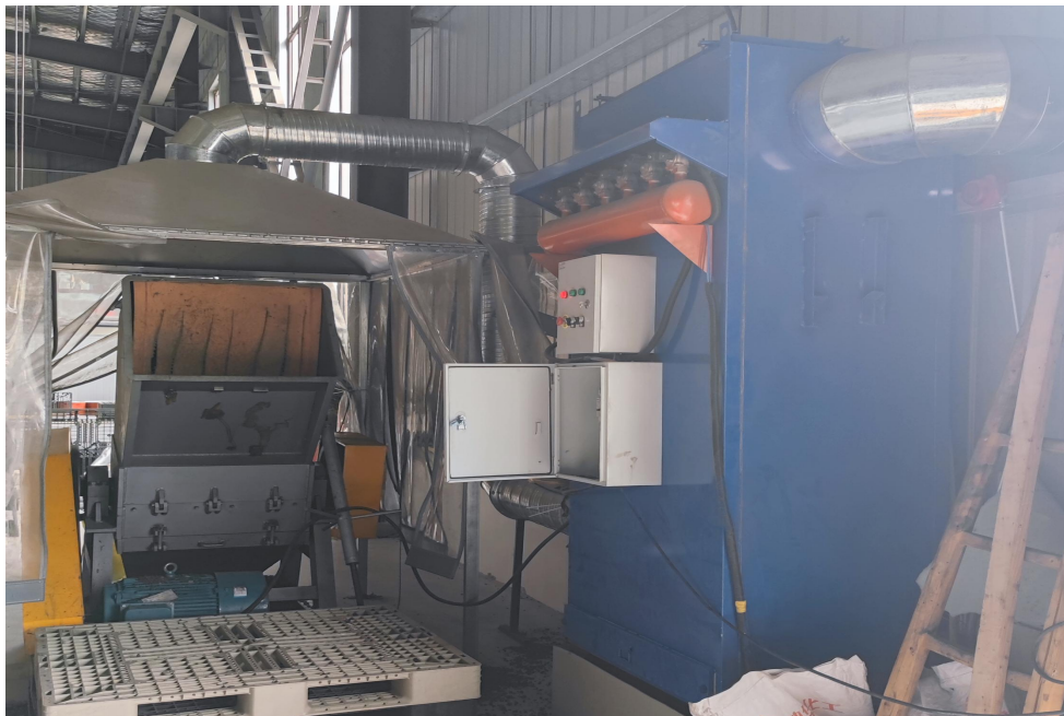
图 4.1-3 破碎粉尘收集及处理装置
